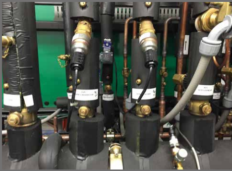
中温冷蔵用ラックシステムの機器バルブ
