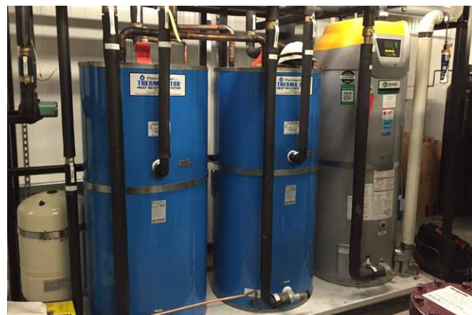
ソルスティスN40を用いた冷凍冷蔵システム、回収熱も利用
